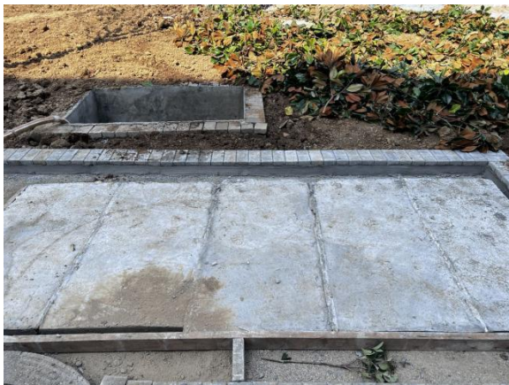
地埋式一体化污水处理设施
